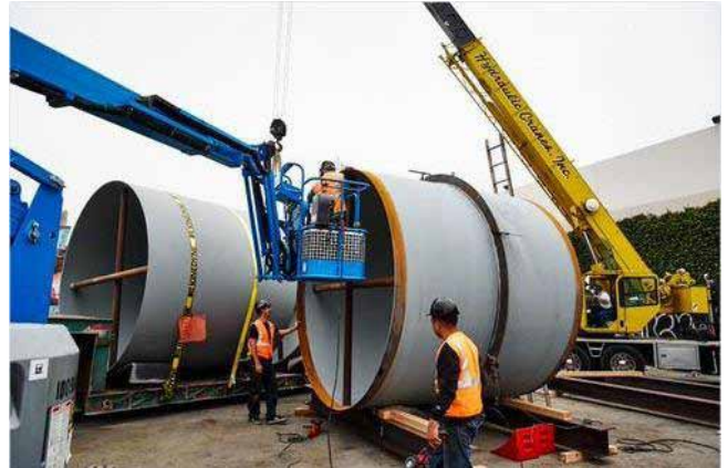
Những chiếc ống thép đầu tiên trong quá trình xây dựng Hyperloop.
