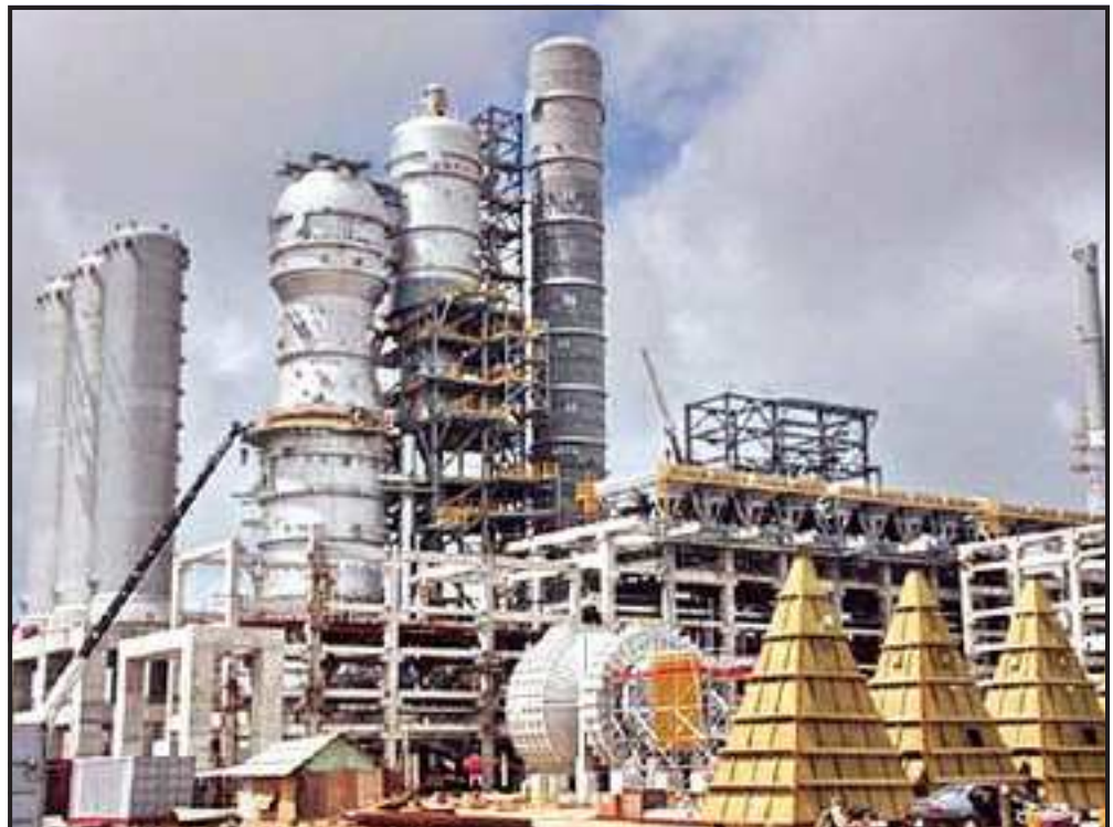
Một góc nhà máy lọc dầu Dung Quất
